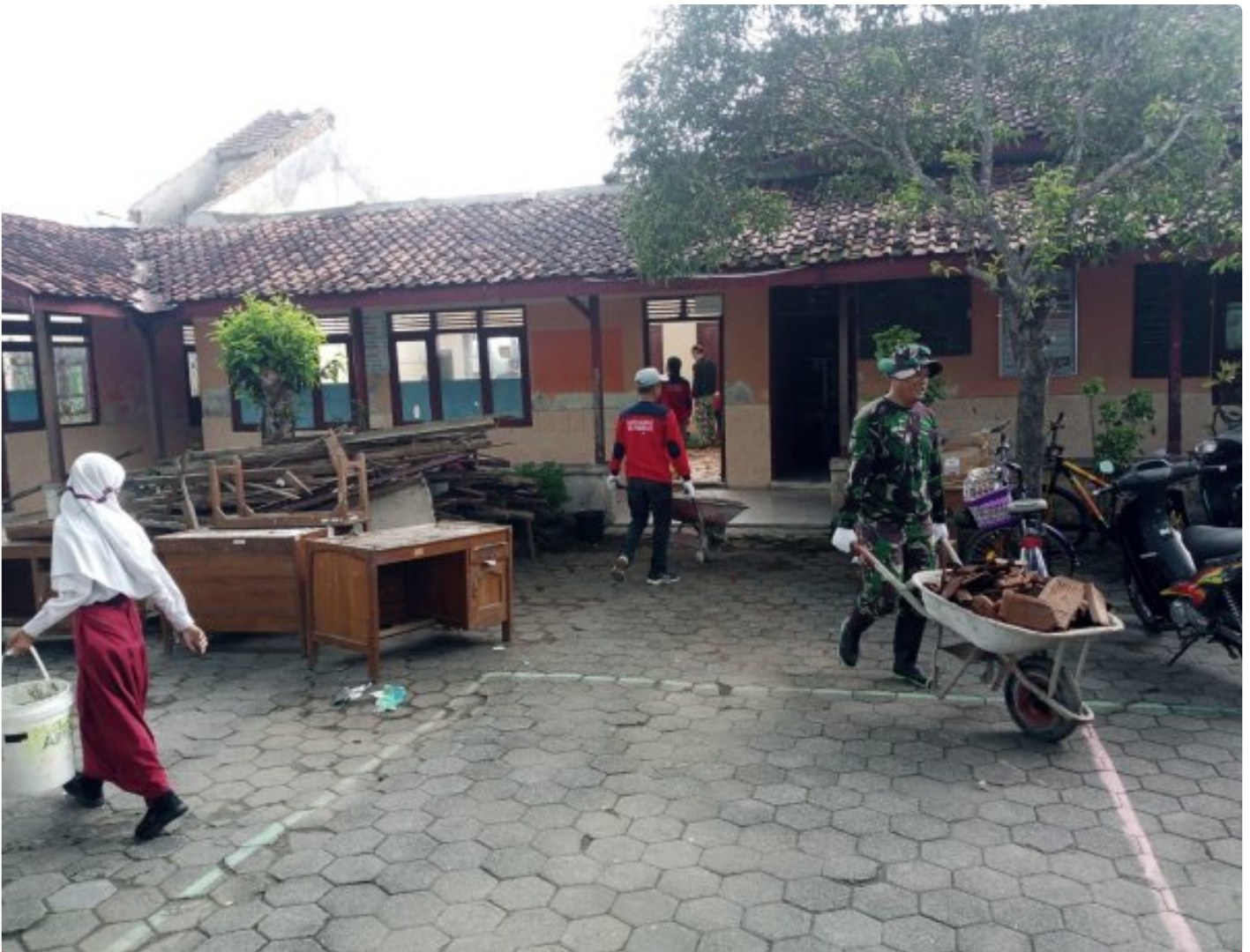
Babinsa Koramil 19 Trucuk Gotong Royong Pembersihan Gedung SDN 2 Pundungsari Yang Roboh
